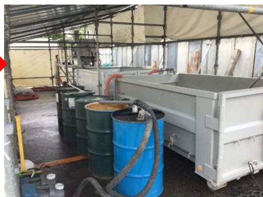
汚水浄化槽及び汚泥回収ドラム
