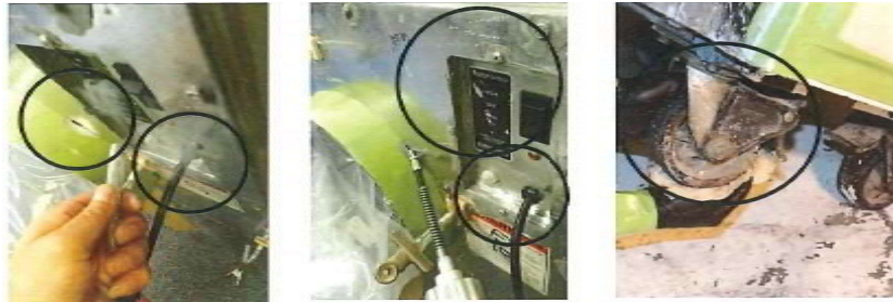
漏れの発生しやすい箇所
